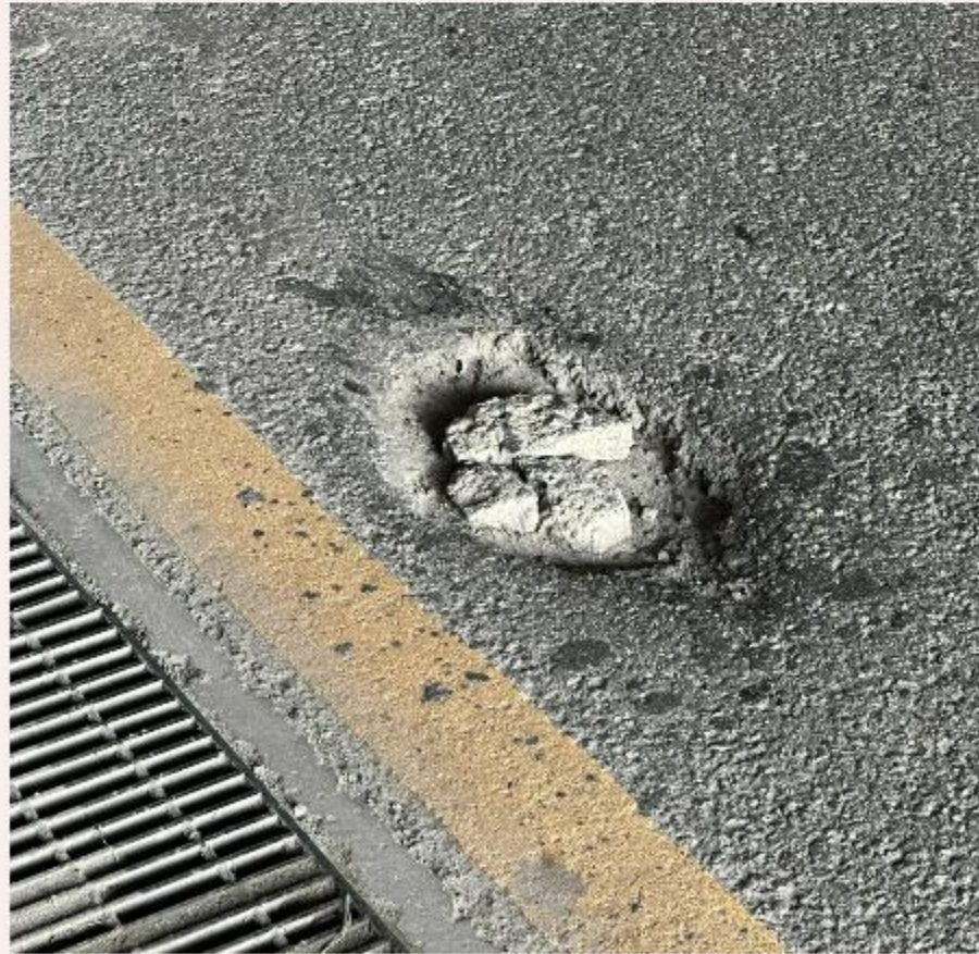
신도시 부근 싱크홀 발생
